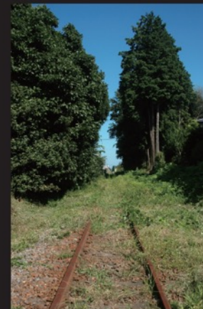
舗装前 生命力旺盛な緑が、 線路跡を一面に覆っています。
